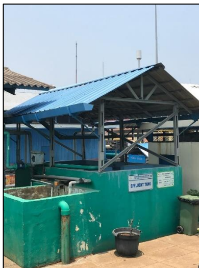
Gambar 2.11 Unit Effluent (Sumber: Dokumentasi Lapangan Tahun 2023)
