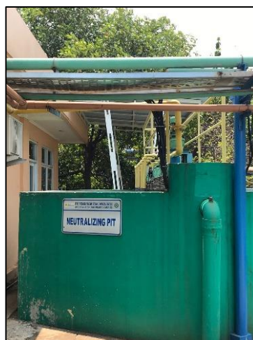
Gambar 2.8 Unit Neutralizing Pit (Sumber: Dokumentasi Lapangan Tahun 2023)
