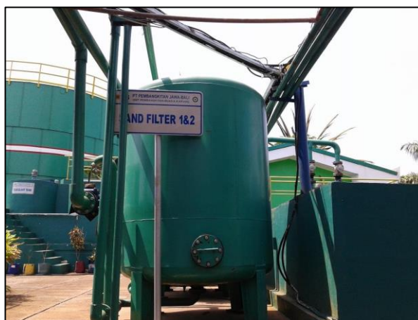
Gambar 2.10 Unit Sand Filter (Sumber: Dokumentasi Lapangan Tahun 2023)
