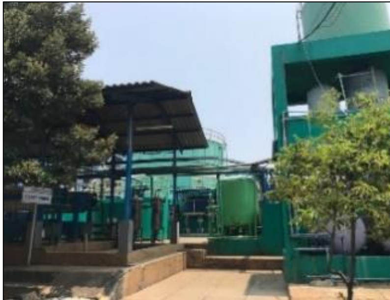
Gambar 4.4 WWTP (Sumber: Dokumentasi Lapangan Tahun 2023)
