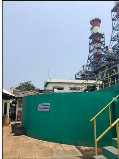
Gambar 2.7 Unit Clarifier (Sumber: Analisis Penulis Tahun 2023)
