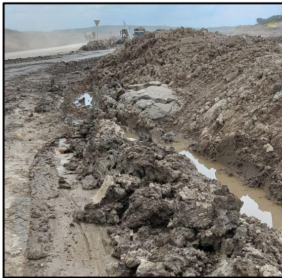
Gambar 5.1 Genangan Air pada Tepi Jalan
