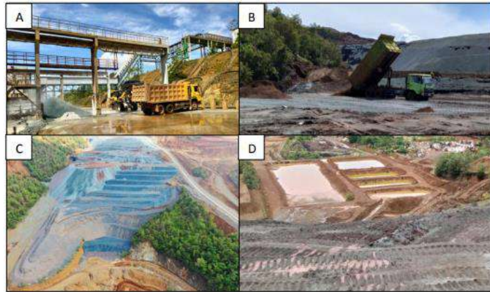
GAMBAR 3. Pengelolaan Sisa Pemanfaatan Slag Nikel; A). Loading Slag Nickel dari Slag Pool ke truck, B). Fasilitas penimbunan Pit Raja Ampat, C). Penataan slag nikel pada Pit Raja Ampat, dan D). IPAL Slag Nikel
