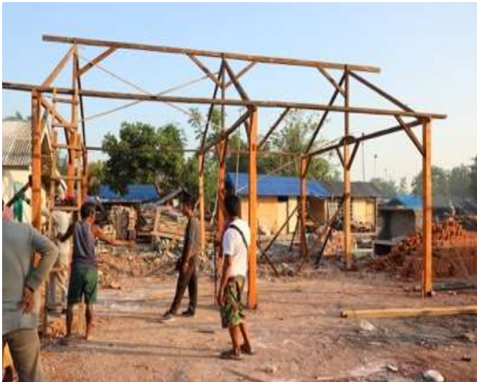
Gambar 9.4. Masyarakat yang terdampak membangun kembali hunian sementara sendiri secara swadaya menggunakan bahan bangunan yang ada.
