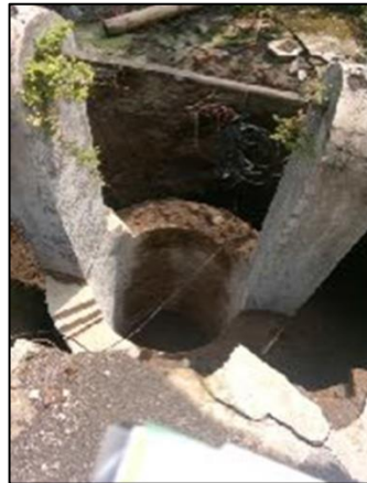
Gambar 5. Foto amblesan sumur di Desa Manggis, Kediri 2017
