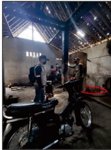
Gambar 2. Peninjauan amblesan sumur di Desa Jungkare bersama perwakilan dari BPBD Klaten (Kiri) dan Kordinator PSMB UPN (Kanan)
