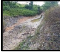
Gambar 6. Kondisi Aktual Saluran Terbuka III
