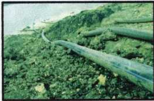
Gambar 4.6 Pipa HDPE pada pit 2 Banko Barat
