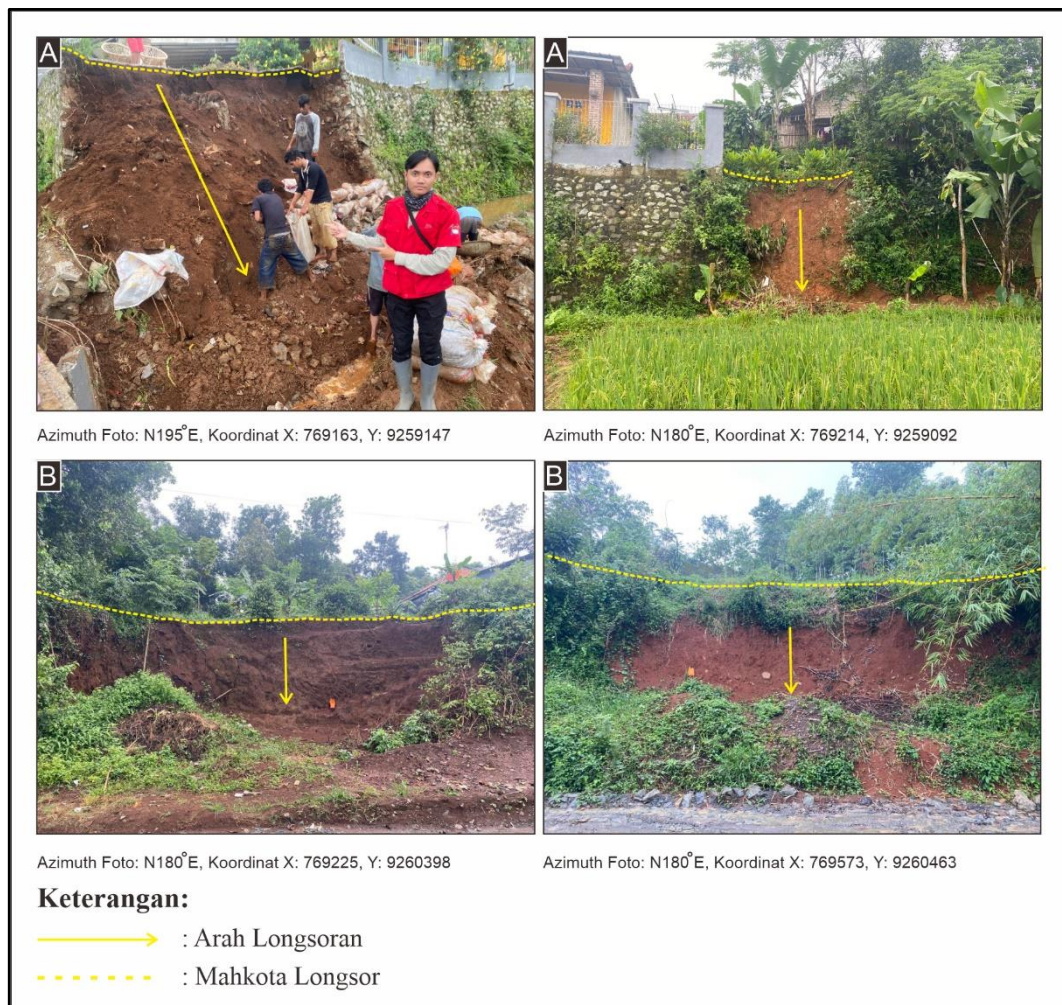
Gambar 6. 2. A) Longsor rotasi pada rumah warga; B) Longsor rotasi pada akses jalan.
