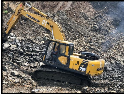
Gambar E. 6 Operator tidak mengenakan APD
