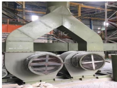
Gambar I.22 Blower penyuplai udara
