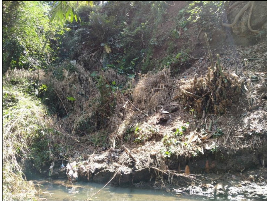
Gambar 6.6 Tanah longsor yang terjadi di LP BG21
