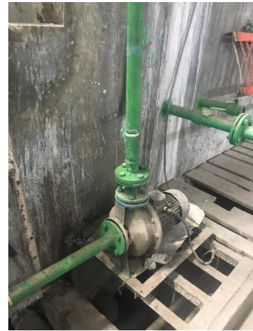
Gambar 10. Pompa air barat
