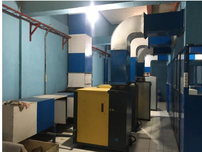
Gambar 1. 23 Ruangan Penyedia Udara Tekan
