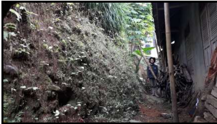
Gambar 6.14. Kenampakan lereng 5 yang berpotensi longsor lokasi pengamatan 128. Lereng berada di Desa Aribaya dengan tinggi 4 meter, lebar 13 meter, panjang sisi miring 4,2 meter dan kemiringan lereng 72^{\circ} . Azimuth N 176^{\circ} E
