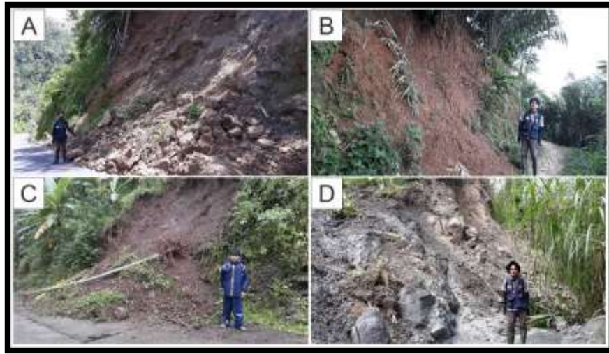
Gambar 5.35. Potensi negatif pada lokasi penelitian berupa gerakan massa. Gerakan yang terjadi di Desa Limbangan pada lokasi penelitian 103 (A). Gerakan yang terjadi di Desa Clapar pada lokasi penelitian 9 (B). Gerakan massa yang terjadi di Desa Limbangan pada lokasi penelitian 107(C). Gerakan massa yang terjadi di Desa Clapar pada lokasi penelitian 8(D).
