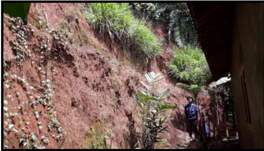
Gambar 6.8. Kenampakan lereng 3 yang berpotensi longsor pada lokasi pengamatan 126. Lereng berada di Desa Gunung giana dengan tinggi 7,7 meter, lebar 9,8 meter, panjang sisi miring 8 meter dan kemiringan lereng 73^{\circ} . Azimuth N 210^{\circ} E.
