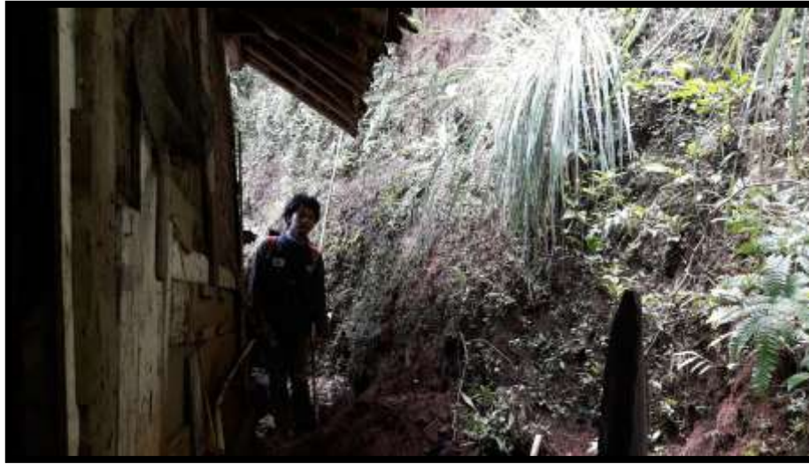
Gambar 6.17. Kenampakan lereng 6 yang berpotensi longsor lokasi pengamatan 129. Lereng berada di Desa Limbangan dengan tinggi 7 meter, lebar 12,5 meter, panjang sisi miring 7,1 meter dan kemiringan lereng 80^{\circ} . Azimuth N 131^{\circ} E
