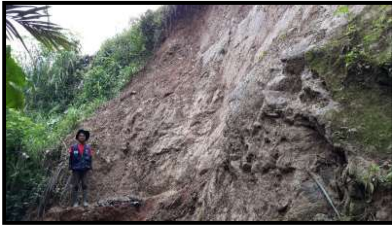
Gambar 6.5. Kenampakan lereng 2 yang berpotensi longsor pada lokasi pengamatan 125. Lereng berada di Desa Clapar dengan tinggi 9 meter, lebar 13,3 meter, panjang sisi miring 10,4 meter dan kemiringan lereng 61^{\circ} . Azimuth N 291^{\circ} E
