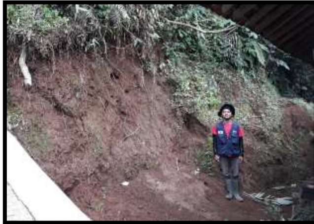
Gambar 6.2. Kenampakan lereng 1 yang brepotensi longsor pada lokasi pengamatan 124. Lereng berada di Desa Talunamba dengan tinggi 4,2 meter, lebar 5 meter, panjang sisi miring 4,7 meter dan kemiringan lereng 71^{\circ} . Azimuth N 030^{\circ} E
