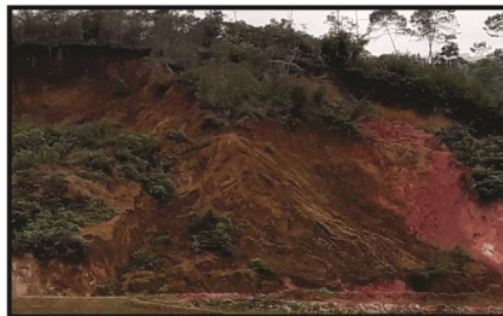
Gambar gerakan tanah tipe aliran tanah ( earth flow ) di barat daya Sungai Cisuwen (LP 49)
