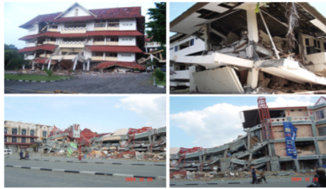
Gambar 1. Dampak Gempa Terhadap Bangunan
