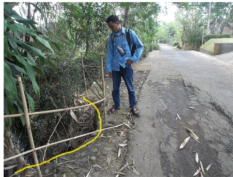
Gambar 16. Bekas longsoran di tepi jalan
