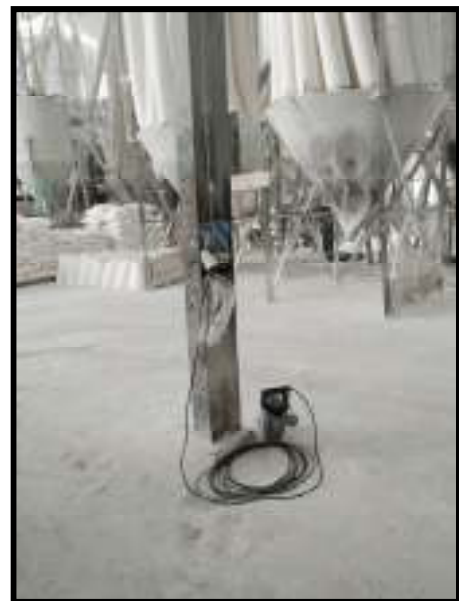
Gambar 4. Kabel Listrik Peralatan Perkakas yang Tidak Diberi Jalur Khusus
