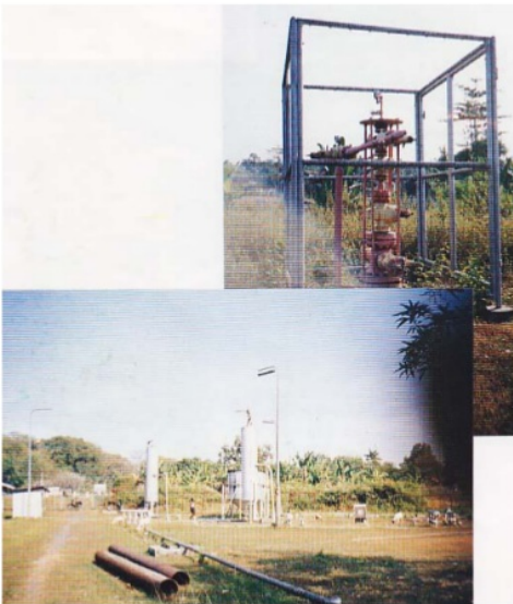
Gambar 6. Sumur Gas PM # 1 di Lapangan Gas Balun - Cepu, dilengkapi dengan unit separator ( foto bawah ), Gas berasal dari reservoir batupasir foraminifera Formasi Selorejo, berada pada kedalaman 300 meter dari permukaan tanah.
