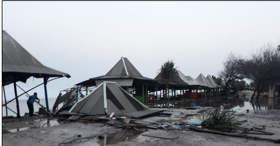
Gambar 5.1. Kerusakan Akibat Gelombang Pasang pada 24 Juli 2018 di Pantai Sepanjang (Sumber: news.detik.com, 26 Juli 2018)
